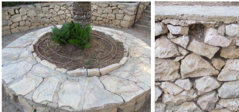
איור 6- סדקים וחוסר באבנים
